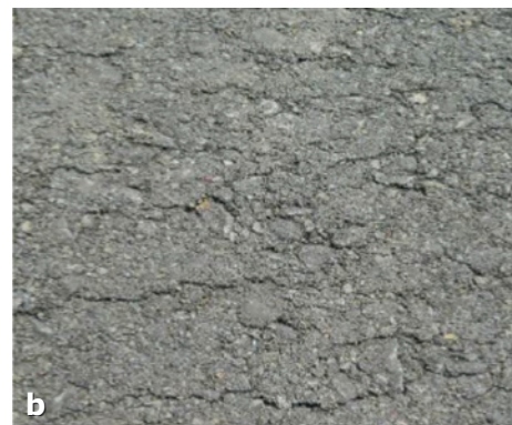
Fig. 2 a,b - Microfisuri de suprafață cauzate de compactarea mixturii asfaltice sub temperatura normată recomandată la această operație tehnologică
