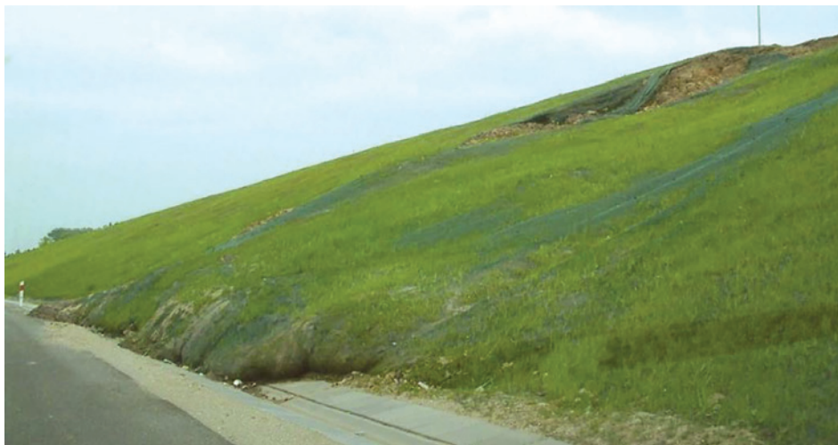
Foto 1 - Cedarea unui taluz cu o înclinare de aproximativ 25°, asigurat cu geotextil/rețea de control a eroziunii pentru revegetare și fără țintuire.
