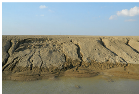
Fig. 9 - Acumulări de apă pluvială la piciorul taluzului
