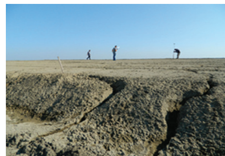
Fig. 5 - Ravenări pe taluzurile neprotejate în timpul execuției
