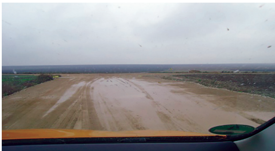
Fig. 13 – Efectul neasigurării cu pante transversale pentru scurgerea apelor pluviale
