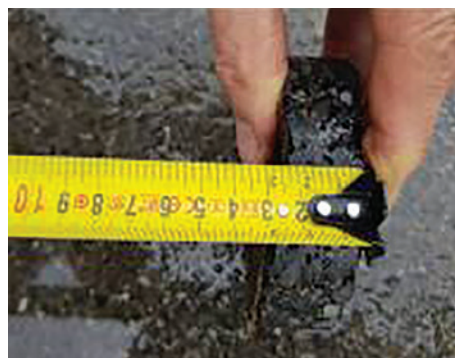
b. grosimea stratului asfaltic sub cea prescrisă prin proiect
