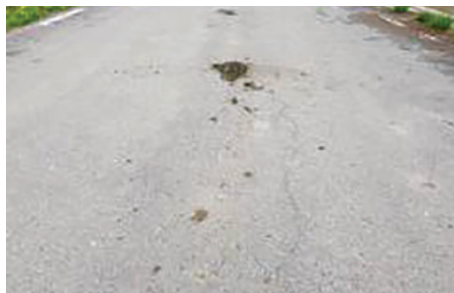
b. fisuri longitudinale
