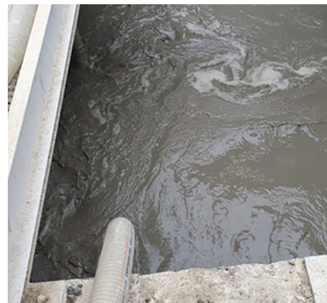
Fig. 1 - Aspectul apei recuperate în urma spălării automalaxoarelor de beton, a pompelor etc. De cele mai multe ori, această apă este excesiv de încărcată cu părți fine, asupra ei aplicându-se o metodă de amestecare energetică anterior preluării prin pompare în vederea utilizării în beton
