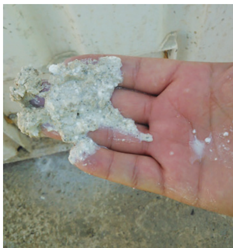
Fig. 2 - Aspectul depozitelor de părți fine nocive (granule de ciment hidratat, argilă, praf etc.) de pe pereții unui bazin de decantare
