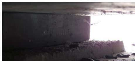
Figura 6 - Lipsa contactului pe întreaga suprafață de rezemare
