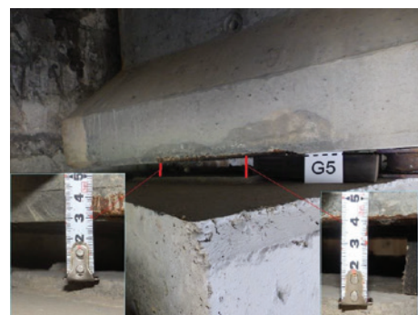
Figura 3 - Lipsa de paralelism între placa din grindă și suprafața cuzinetului
