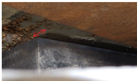
Figura 5 - Grinda alunecată la un aparat fixat la partea inferioară cu mortar
