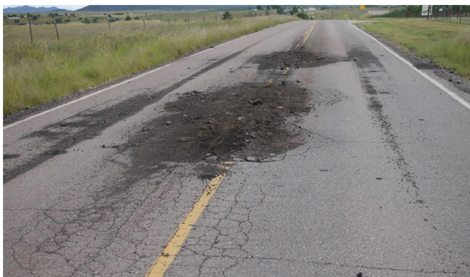
Figura nr. 1 - Șosea degradată ca urmare a diferitelor agresivități
