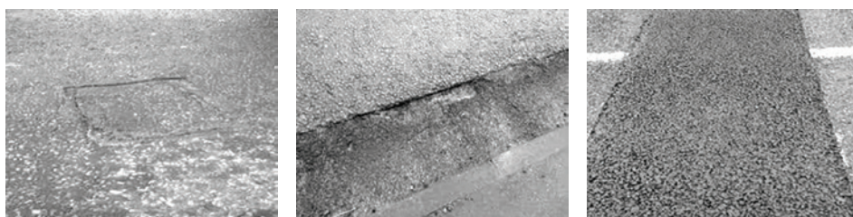
Figura 15 - Efectul compactării scăzute și neuniforme - dislocarea plombei începând cu zonele perimetrice
