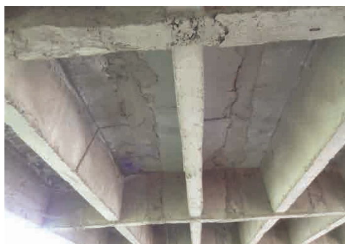
Fig. 8. Intradosul suprastructurii de pe DJ 103K prezintă infiltrații minore după 16 ani, doar pe zonele unde s-au efectuat reparații locale ale căii care au afectat hidroizolația.
