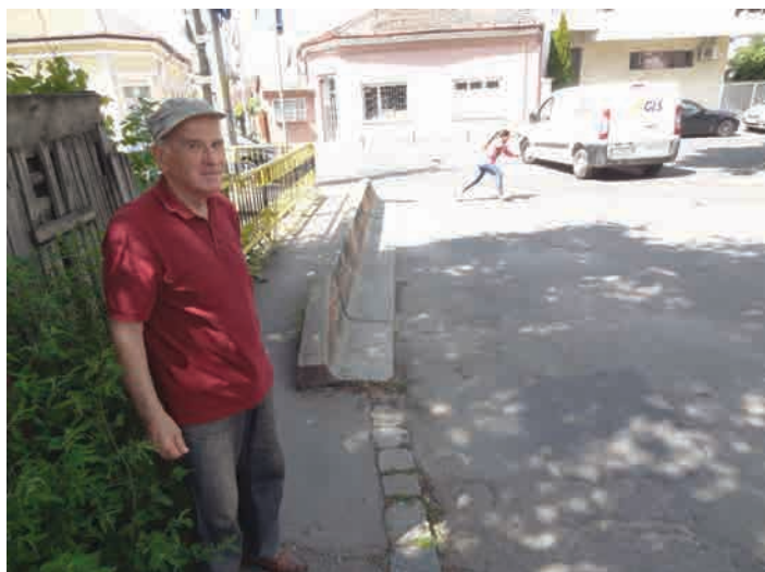
Fig. 5. Pod pe strada Oțetului din Cluj-Napoca, hidroizolat în anul 2001. Cale degradată.
