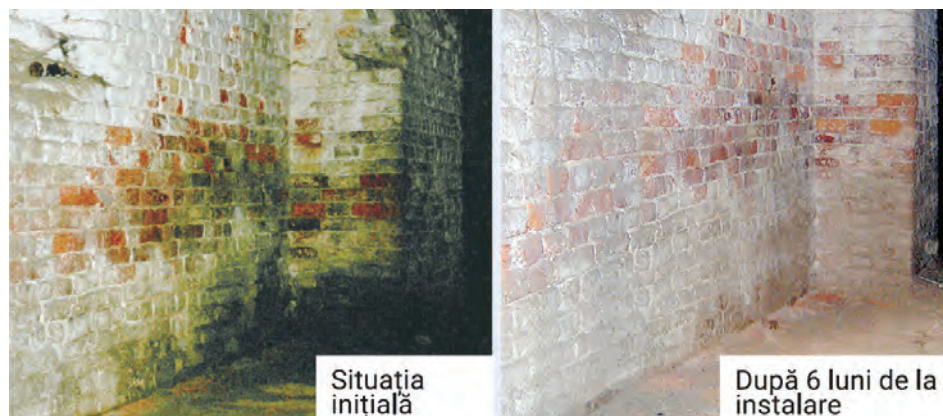
Figura 3 Zidărie afectată de apa capilară – înainte și după montarea echipamentului [4]
