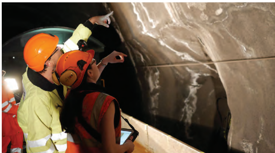
Figura 1 Infiltrații de apă în căptușeala tunelului [3]
