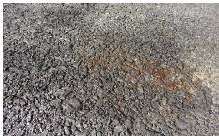
Figura 1 – Degradare sub formă de pată de culoare deschisă-ruginie însoțită de lichid
