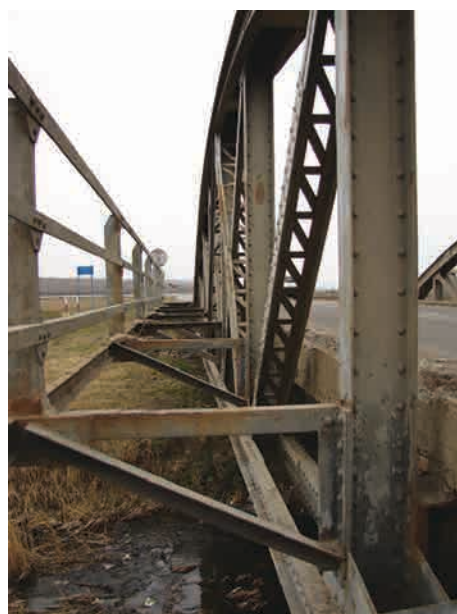
Fig. 5. Trotuarele podului sunt puternic degradate
