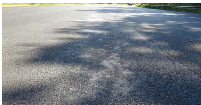
Figura 5 – Degradare sub formă de pată uscată
