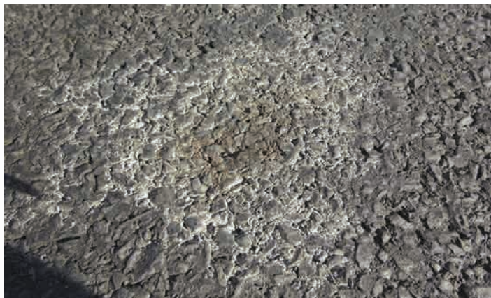
Figura 2 – Identificarea vizuală a degradării de culoare deschisă
