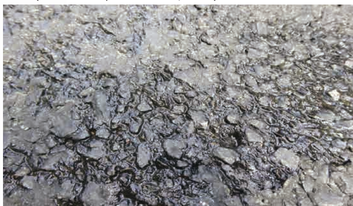
Figura 3 – Degradare însoțită de lichid
