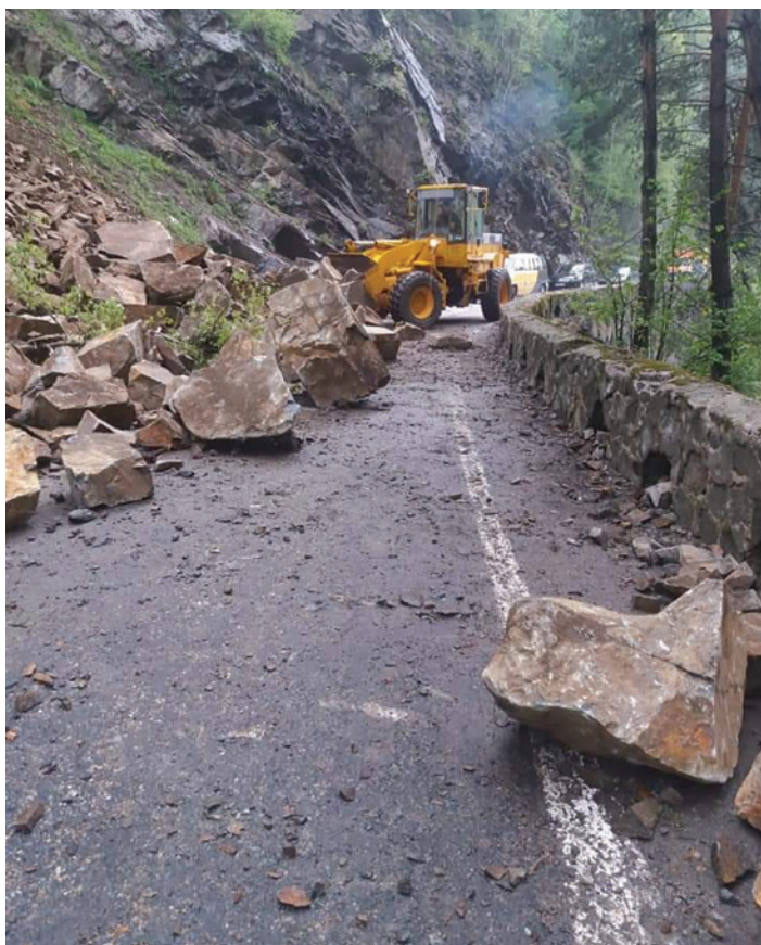
Foto 1: Căderi blocuri de rocă, DN7C
