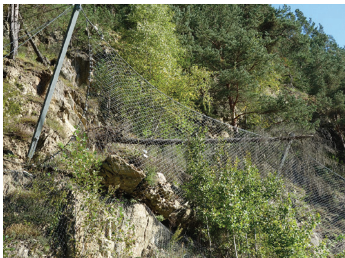
Foto 3: Barieră pe DJ105G, blocuri de rocă și un copac oprit fără cedarea plasei din oțel de înaltă rezistență
