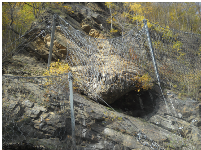
Foto 5: Iulie 2013 - barieră de 3.000 kJ reținând aproximativ 8 m³ de material (DN7 km 206+000)
