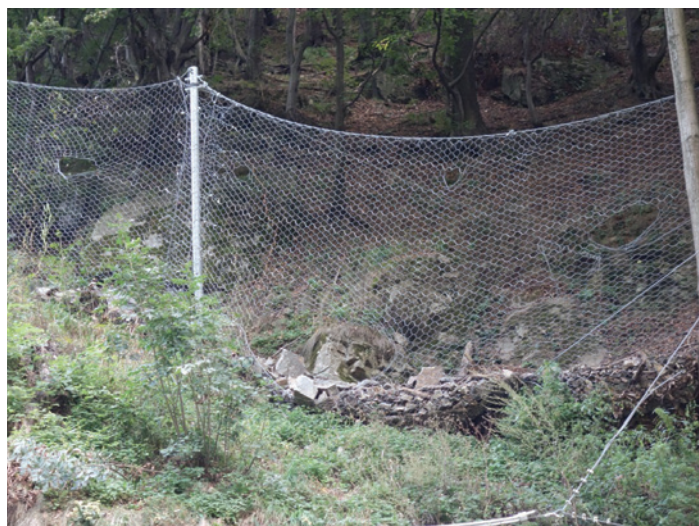
Foto 4: Barieră pe DN66, retenție parțială de material la bază dar plasa din oțel moale este perforată în jumătatea superioară în mai multe locuri
