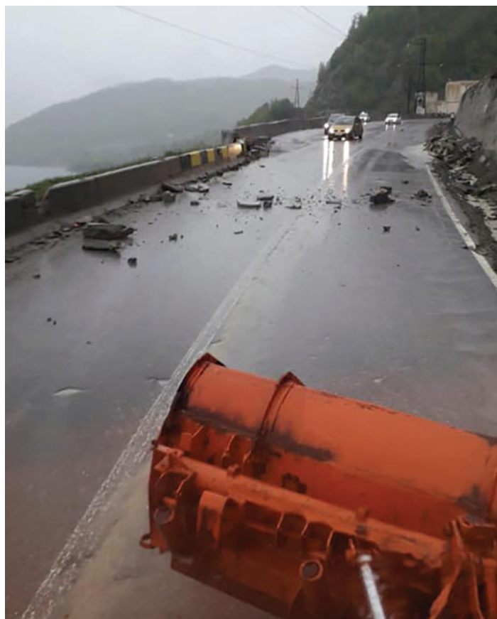
Foto 2: Căderi blocuri de rocă, DN10
