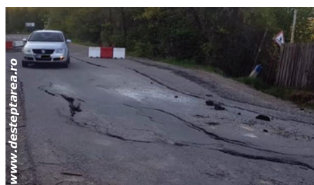
Figura 3 – DN 12B, km 0+452 – km 0+487 degradări datorate reactivării unor alunecări de teren
