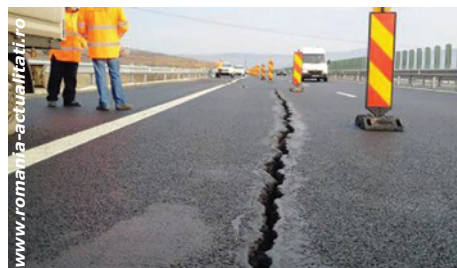
Figura 5 – Degradări pe Autostrada Sibiu - Orăștie
