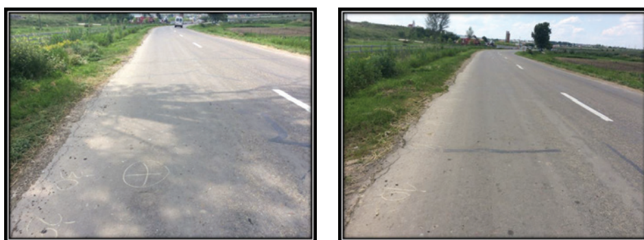
Figura 4 – Fotografii, de pe sectorul studiat, cu degradări de tip fisuri și crăpături de margine
