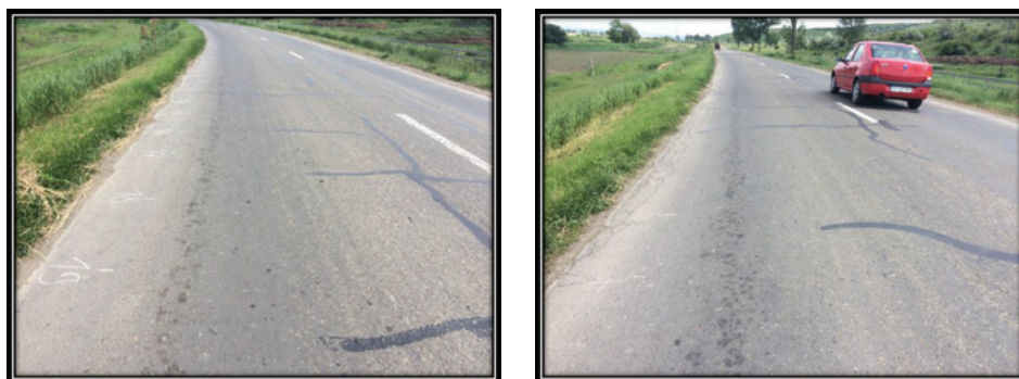
Figura 5 – Fotografii, de pe sectorul studiat, cu degradări de tip suprafață exudată
