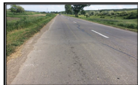
Figura 1 – Fotografii, de pe sectorul studiat, cu degradări de tip fisuri sau crăpături longitudinale
