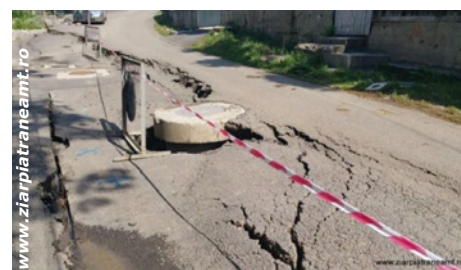
Figura 4 – Cedare infrastructură rutieră datorată tasării terenului de fundare
