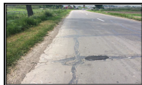
Figura 2 – Fotografii, de pe sectorul studiat, cu degradări de tip suprafețe plombate
