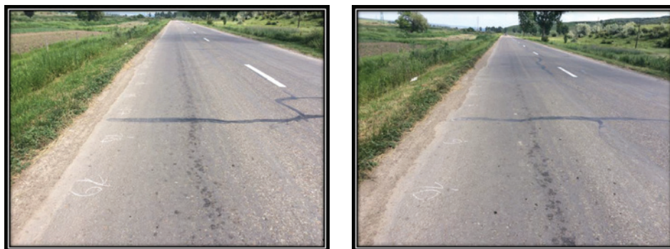
Figura 3 – Fotografii, de pe sectorul studiat, cu degradări de tip fisuri și crăpături transversale
