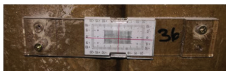
Figura 1 – Dispozitiv de monitorizare a evoluției fisurilor
