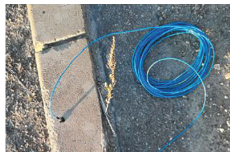
Figura 10 – Cabluri de transmitere a datelor în cadrul sistemelor SHM
