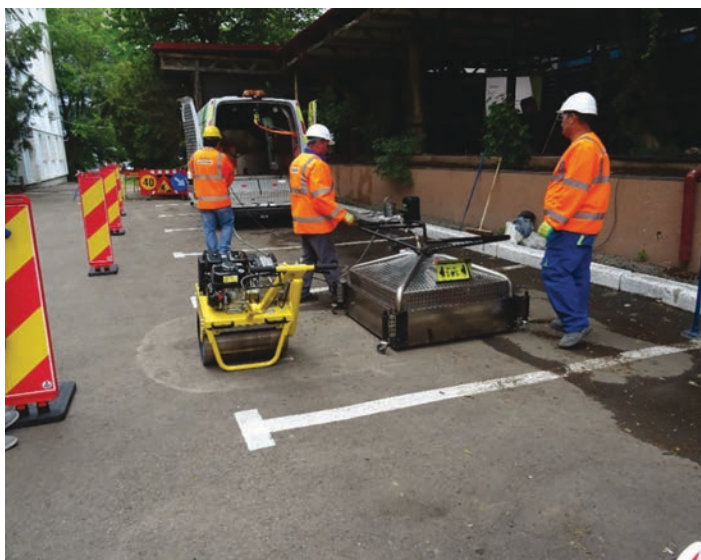
Foto 2: Autoutilitara, cilindrul compresor și panoul radiant
