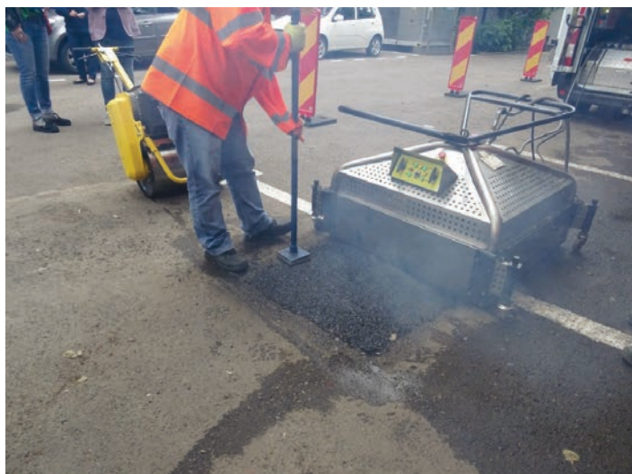
Foto 9: Panoul radiant încălzește suprafața adiacentă care a fost udă și de aceea iese aburi.
