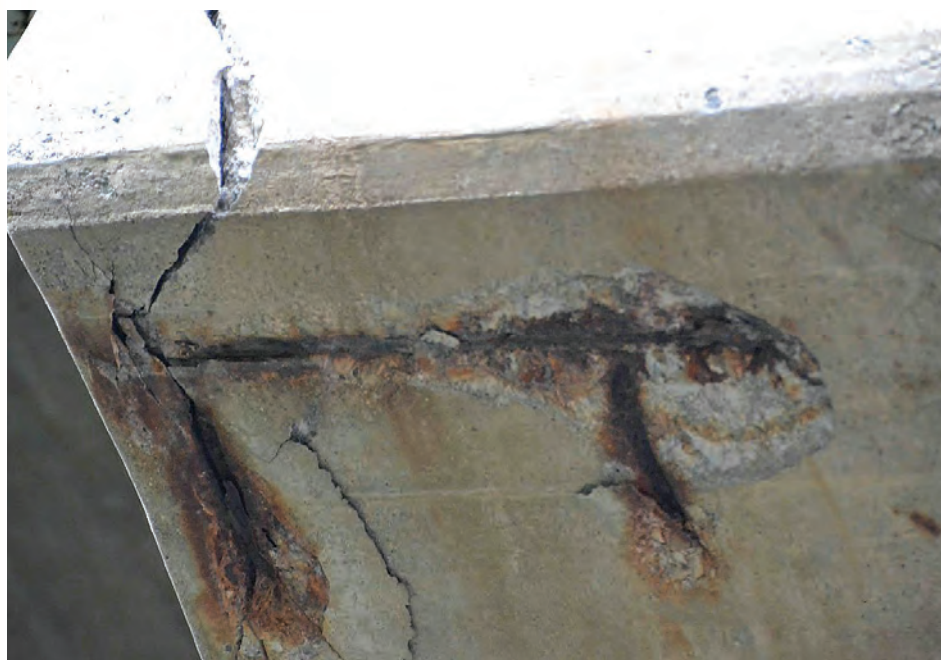
Degradarea structurilor din beton
