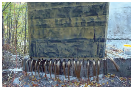
Fig. 10 Consolidarea zonelor puternic corodate cu sârme flexibile de înaltă rezistență
