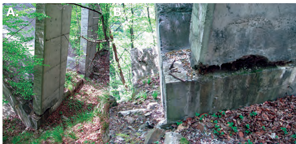
Fig. 5 Degradări la îmbinarea stâlpului de capăt cu bolta a) Vedere generală - b) Detaliu
