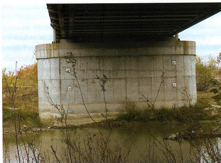
Foto 1 - Pila „cap Y”. Se remarcă folosirea pentru fretare a unor contraplăci de dimensiuni reduse, fixate pe tije filetate
