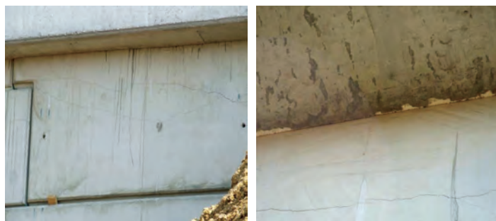
Figura 4 - Fisurarea panourilor superioare de 30 kN, de sub grinda parapet
