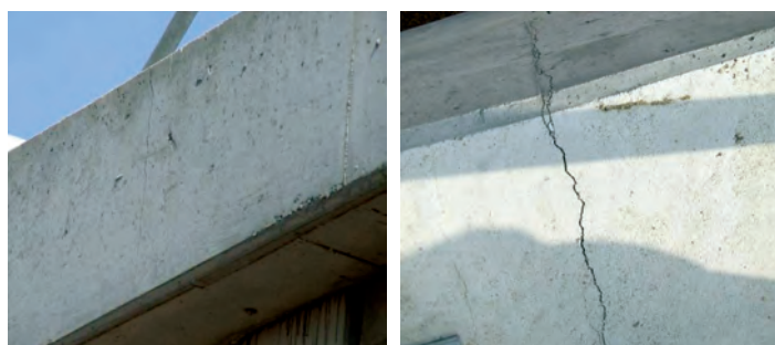
Figura 5 - Fisuri în grinda parapet
