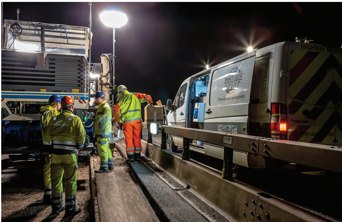
Timpul extrem de scurt în care dala continuă de beton putea fi turnată, pe Autostrada M6, în timpul nopții, nu a depășit niciodată șase ore
