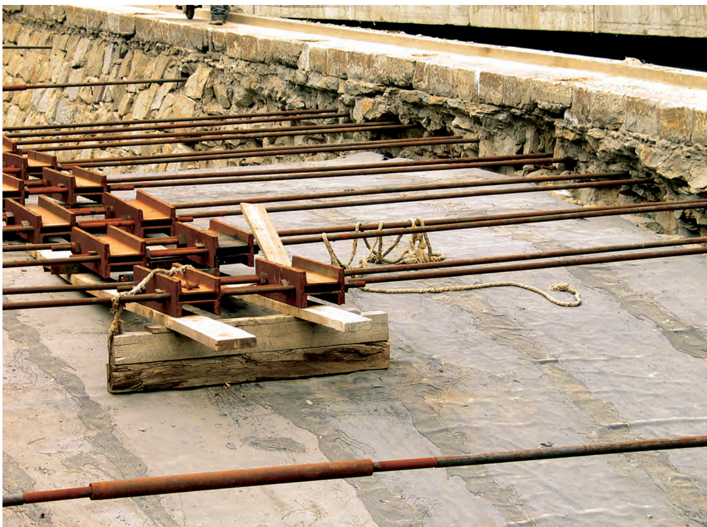
Fig. 200 - Podul peste râul Oituz, la Poiana Sărată Detaliu de tiranți întinzători utilizați pentru preluarea deformațiilor timpanelor în secțiunea transversală
