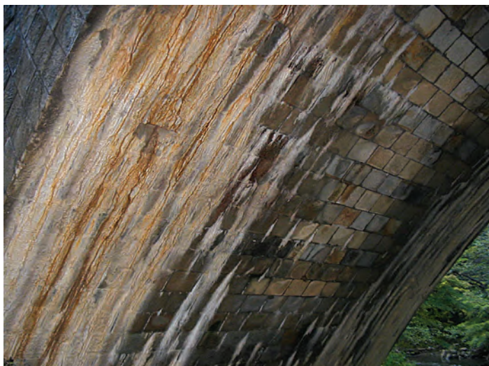
Fig. 193 - Podul peste râul Oituz, la Poiana Sărată. Eroziunea pietrei naturale a bolții (Foto, S. FLOREA, 2002)
