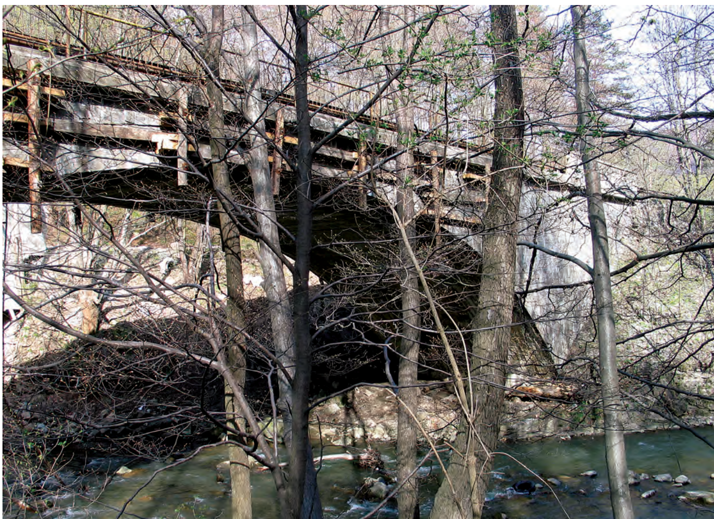
Fig. 195 - Podul peste râul Oituz, la Poiana Sărată. Măsuri provizorii pentru a evita prăbușirea timpanelor. Elevația amonte (Foto, S. FLOREA, 2002)
