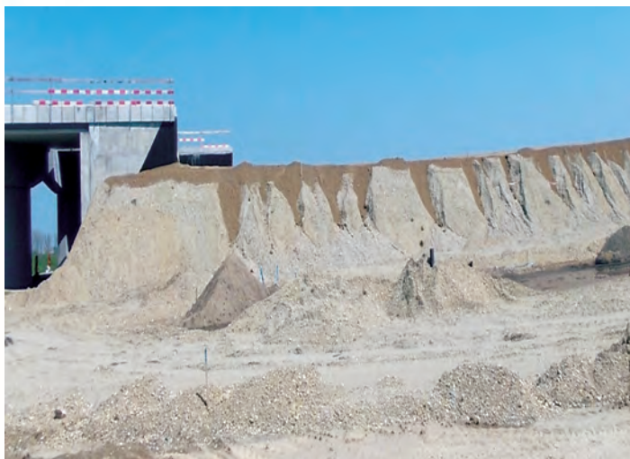
Figura 5 - Eroziunea taluzului la rampa de acces pe pod 3
