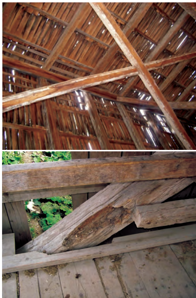
Figura 5 - Degradări ale elementelor structurale la nivelul suprastructurii
