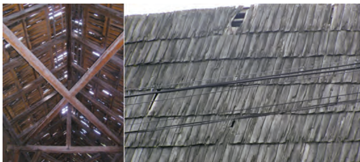
Figura 6 - Degradări ale învelitoarei din șindrilă
