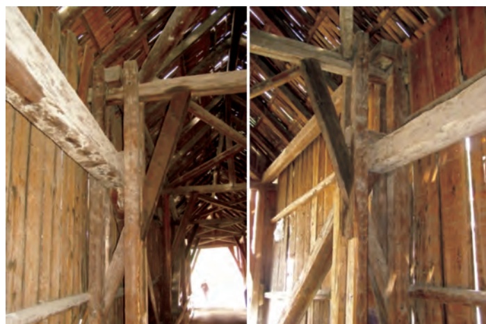
Figura 2 - Aspectul degradat și învechit al lemnului din cadrele transversale care susțin acoperișul
