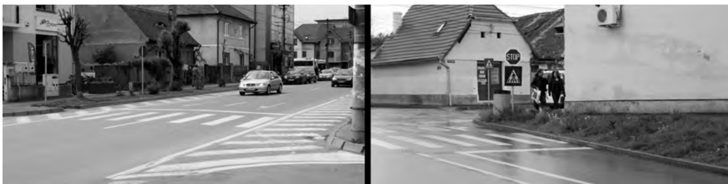
Figura 4 - Coborâri neconforme de pe trotuar pe carosabil
