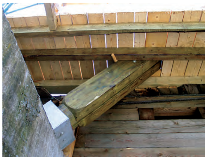
Fig. 176 - Podul de lemn peste râul Tisa, la Sighetu Marmăției. Detaliu de rezemare a contrașiselor pe culeea C 01 , culeea mai stâng. (Foto, S. FLOREA, 2008)
