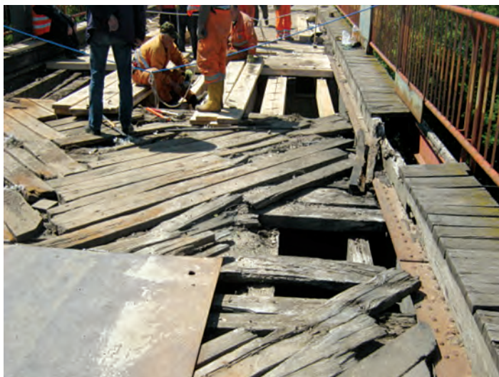
Degradări peste care nu se putea trece
