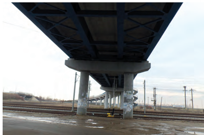
Vedere de jos a pasajului peste liniile de cale ferată ale Stației C.F. Fundulea
