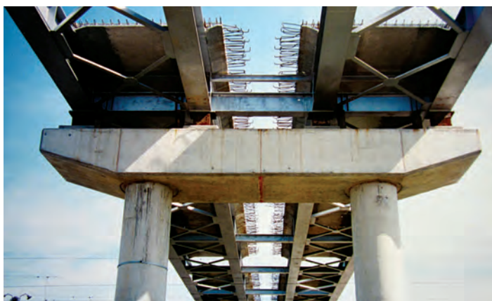
Grindă metalică mixtă a pasajului peste liniile de cale ferată, fără platelaj
