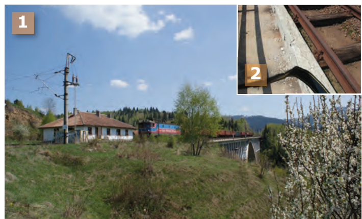
Fig. 136 - 1. Construcțiile existente în zona Viaductului Caracau; 2. Protecția necorespunzătoare a betoanelor (Foto, S. FLOREA, 2012)
