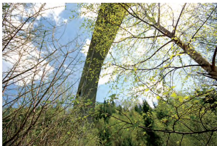
Fig. 125 - Intradosul bolții viaductului Caracău văzut de pe D.J. 124. (Foto, V. PELIN, 2012)
