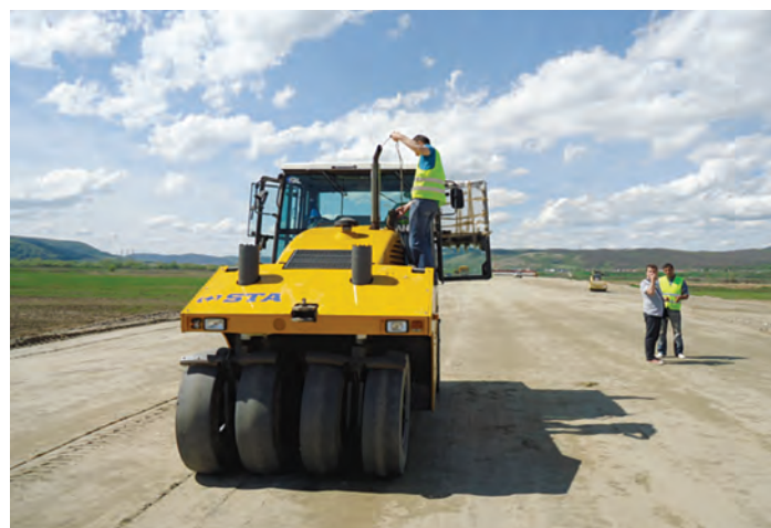
Prelevare probă de aer – emisii de la compactor
