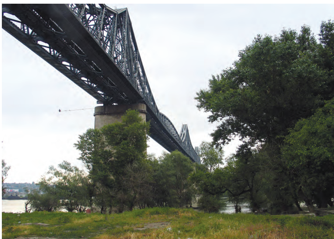
Fig. 112 - Elevația amonte a Podului Dunărea văzut de pe malul stâng al brațului Dunărea, cu obiectivul orientat spre Cernavodă (Foto, S. FLOREA, 2006)
