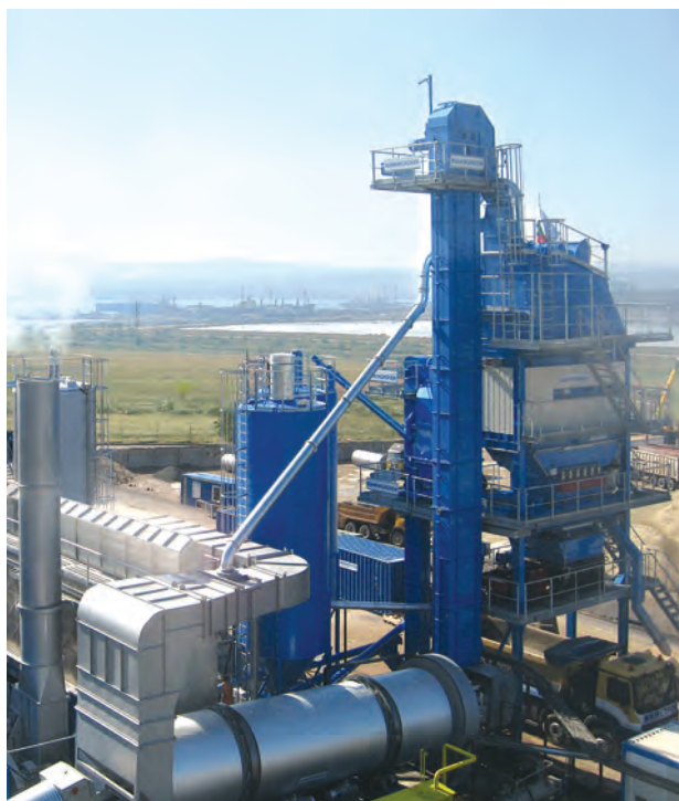
Foto 1. A2 Cernavodă - Constanța: stație de mixturi asfaltice de tip BENNINGHOVEN ECO 4000, pe șantierul de la Cernavodă
