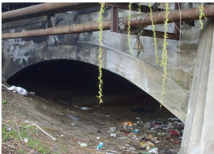
Fig. 062 - Podul de piatră peste râul Cibin, transformat în ladă de gunoi (Foto, S. FLOREA, 2011)
