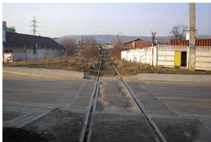
Figura 2. Stare deteriorată a unei treceri la nivel cu calea ferată, Cluj-Napoca
