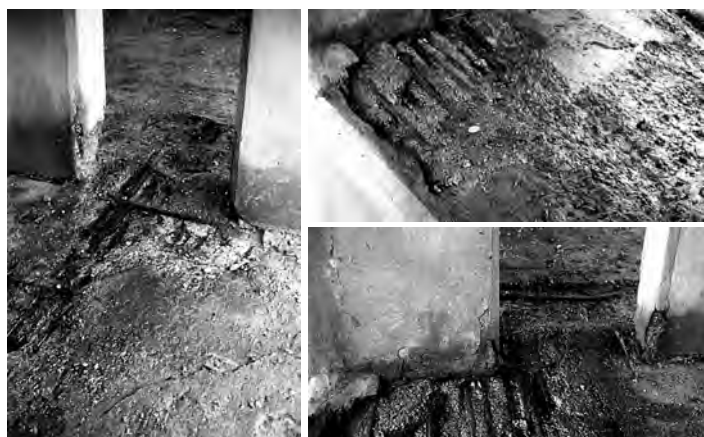
Fig. 037 - Podul peste râul Bârlad, cele mai importante degradări la extradossalul bolții (Foto, S. FLOREA, 1976)
