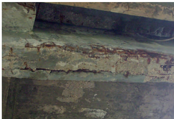
Figura 7 - Degradări ale antretoazei din vecinătatea rostului
