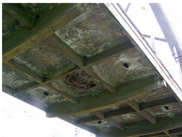
Figura 5 - Degradări ale plăcii la intrados
