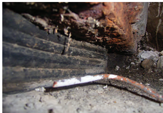
Figura 8 - Deformarea aparatului de reazem
