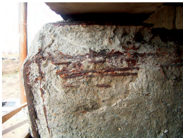
Figura 9 - Lipsa armării cuzinetului pe pilă
