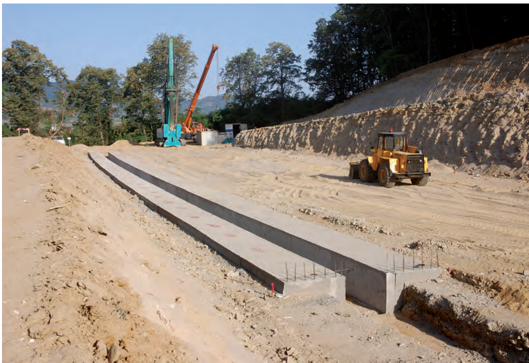
„Grinda de consolidare” pe terenul cu alunecare activă (km 71+840)
