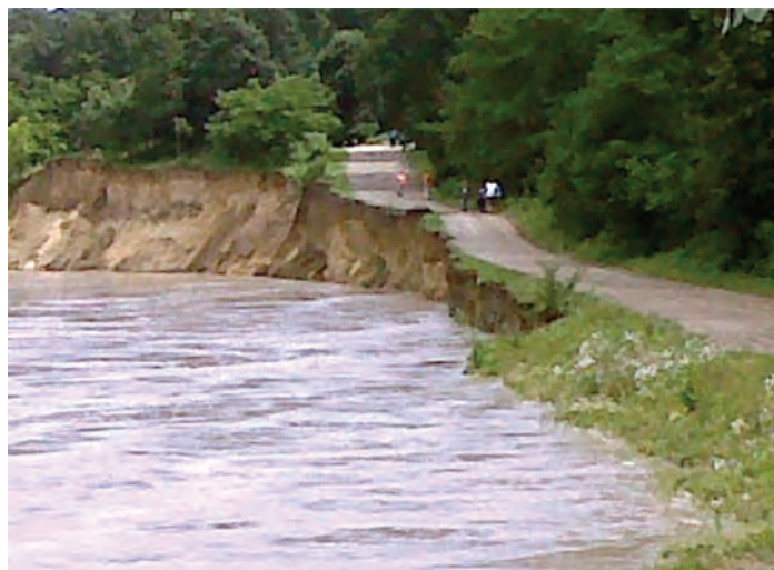
Fig. 020 - Malul stâng al râului Siret amonte de pod, secțiunea în care deplasarea limitei albiei minore stânga pe direcția SV-NE este de aproximativ 300,00 m.
