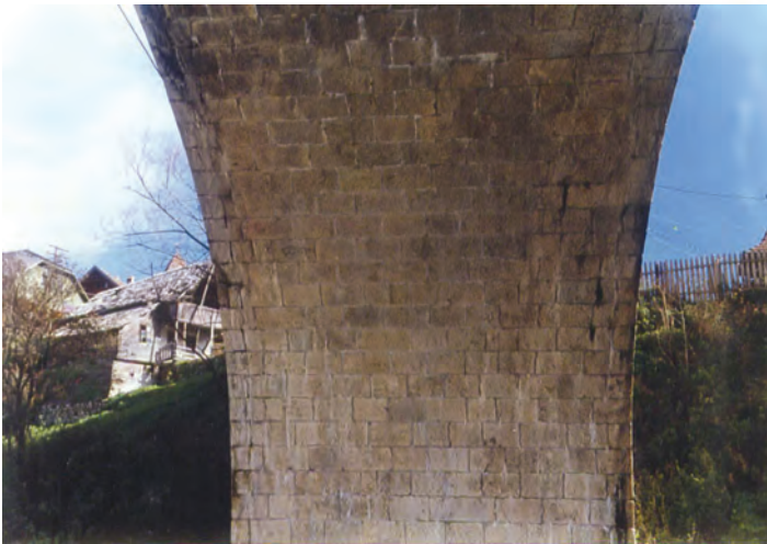
Foto 6 - Crăpături și degradări la intradosul bolții
