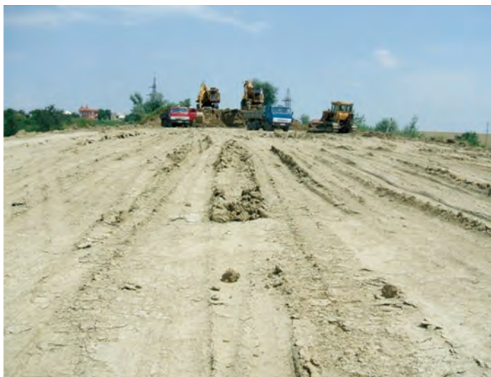
Figura 3. Nucleul terasamentului are umiditate sporită, compactare insuficientă, utilajele de compactare nu pot fi introduse
