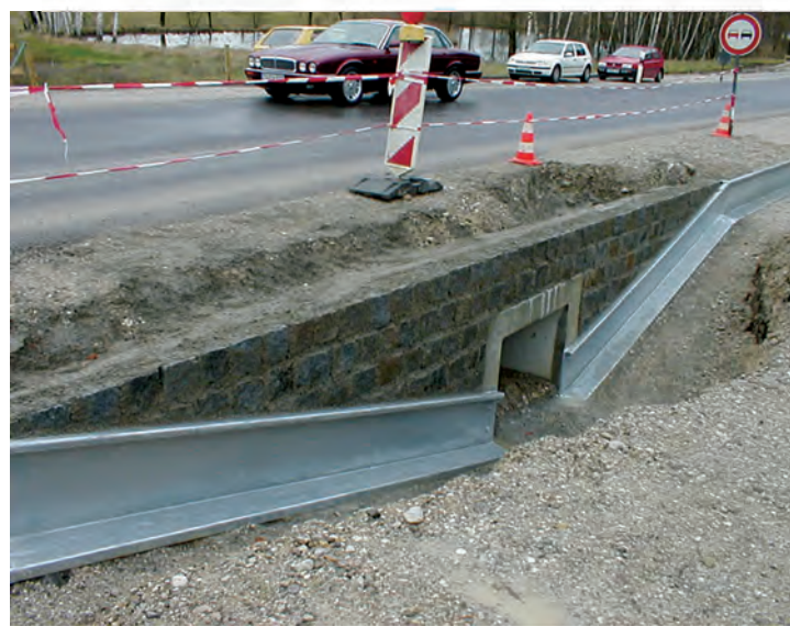
Fig. 3 - Podețe pentru tranzitul amfibienilor și parapete de ghidare
