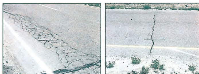
Fig. 38b Fisurare din oboseală Fig. 38c Crăpătură transversală în asfalt din temperaturi negative
