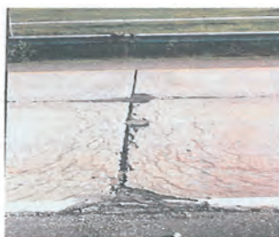
Fig. 38e Largire rosturi și crăpături de colț în beton de ciment
