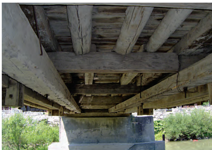
Fig. 4.12 Grinzile principale ale podului de lemn acoperit din comuna George Coșbuc după 74 de ani de exploatare.
