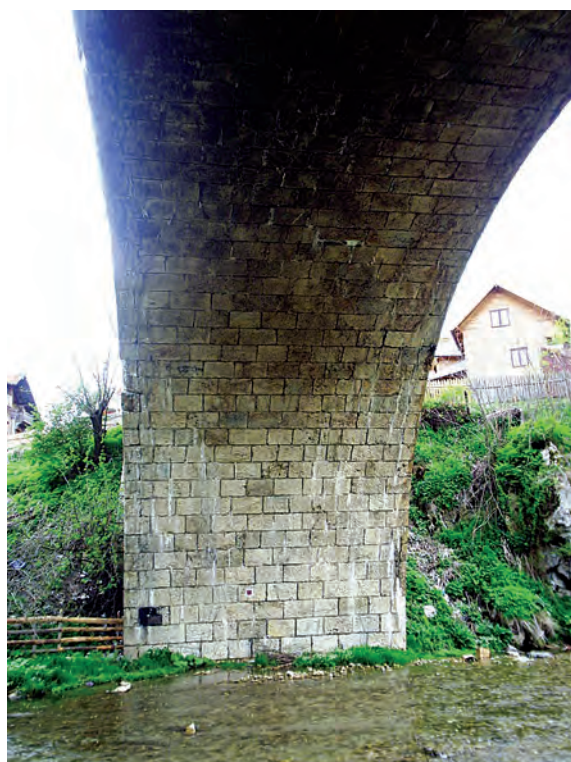
Fig. 4.49 Intradosul bolții la nașterea de pe malul stâng al râului Dâmbovița. Privind cu lupa se observă urme foarte fine ale apariției fenomenului de voalare a timpanului (desprinderi ale timpanului de boltă). Imagini luate în anul 2007, luna martie ziua 10 (Foto S. Florea).
