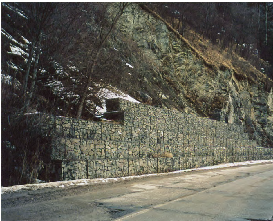
D.N. 17B, km 14+150 - apărarea drumului cu zid din gabioane
