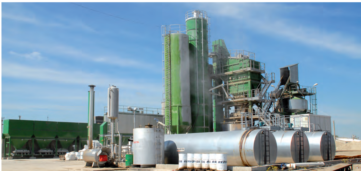
Stația de mixtură asfaltică ecologică din Nanov
