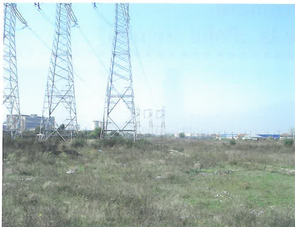
Linia Electrică Aeriană - LEA de 400 kV, în lungul Căii ferate Cluj-Napoca - Oradea, situată la 40 - 70 m față de aceasta
