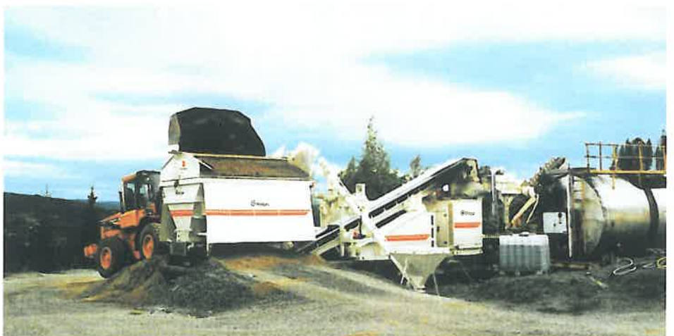
Dozajul redus de ciment face posibilă alimentarea stației de malaxare, din saci vărsați normal în buncărul șnecului dozator
