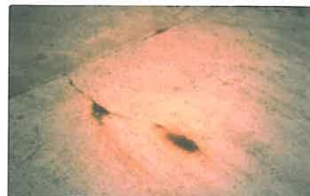
Fig. 1. Fisură în placa de beton armată tradițional, cu urme de rugină provenind de la plasa de oțel
