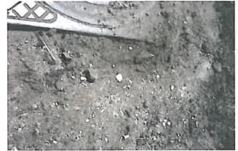
Foto 3. Betonul de pozare și fixare a capacului este deteriorat din cauza expunerii la trafic înainte de perioada de maturare
