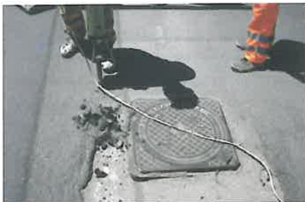
Foto 1. Spargerea asfaltului în jurul ramei capacului după deviere trafic, trasare și tăiere asfalt. Se observă deteriorarea accentuată a asfaltului
