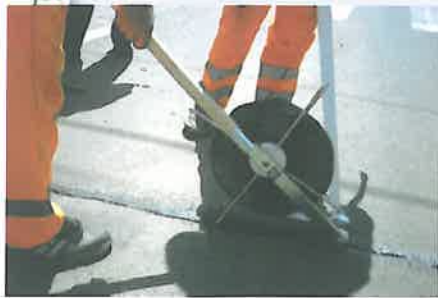
Foto 10. Se aplică banda Rissband pe fisurile amorsate cu ajutorul dispozitivului din imagine, după care se presară nisip cuarțos uscat pentru ruperea aderenței cu pneurile vehiculelor
