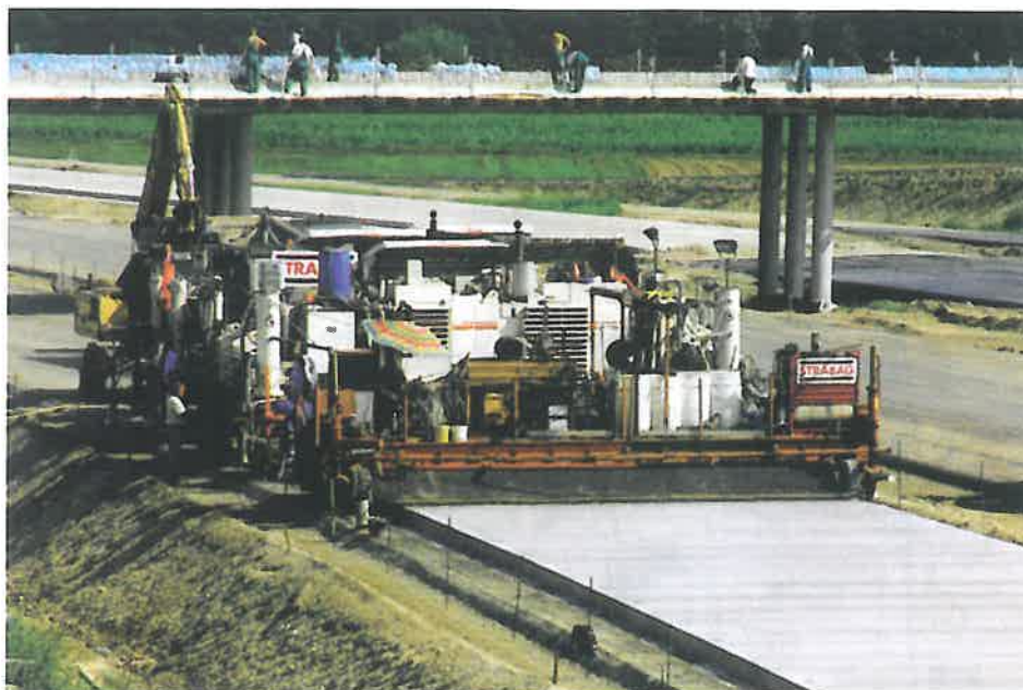
Fig. 4. Așezarea stratului superior de beton în sectorul de est al drumului M0, între km 29-42
