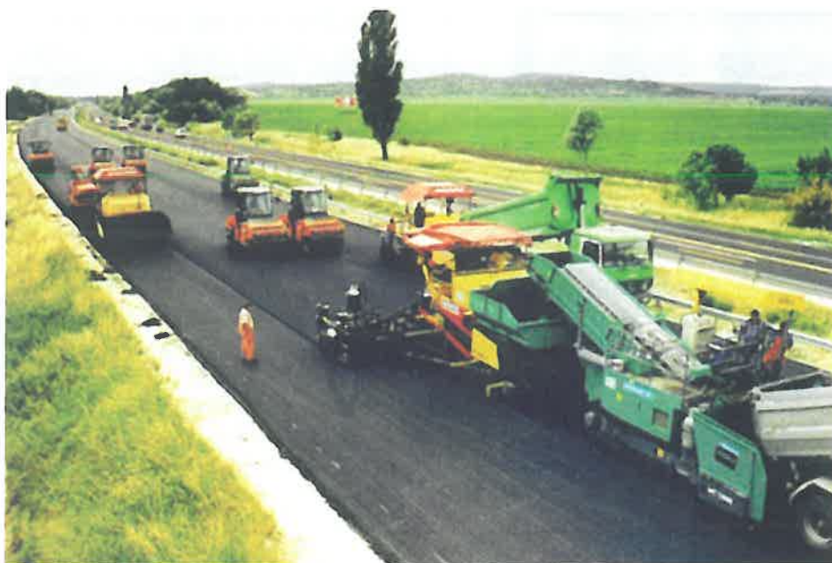
Fig. 5. Așezarea stratului de uzură cu ajutorul instalației de alimentare cu asfalt în cadrul lucrărilor de reconstrucție ale Autostrăzii M7
