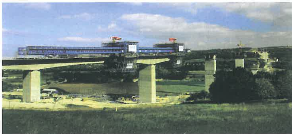
Fig. 9. Starea viaductului de la Koroshegy al Autostrăzii M7 în toamna anului 2005
