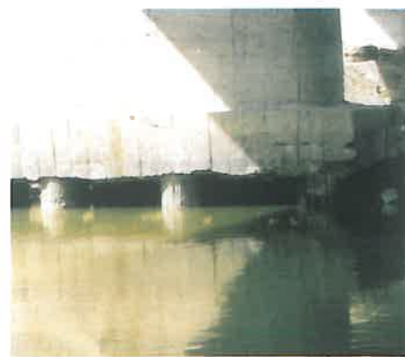
Foto 6. Coborâre talveg și distrugerea completă a betonului în pilot
