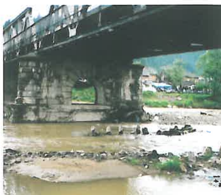
Foto 5. Degradări ale elevației și coborâre talveg
