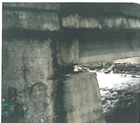
Foto 1. Degradări ale betonului în zona rostului de dilatație
