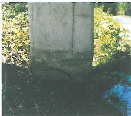
Foto 3. Beton degradat la rostul de turnare stâlp-pilot forat
