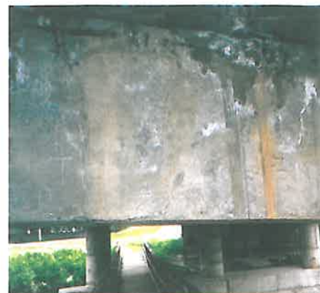
Foto 4. Degradări ale betonului în riglă
