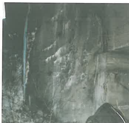
Foto 2. Infiltrații prin infrastructură
