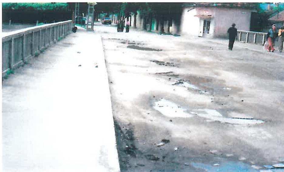
Foto 3. Degradări la îmbrăcămintea căii
