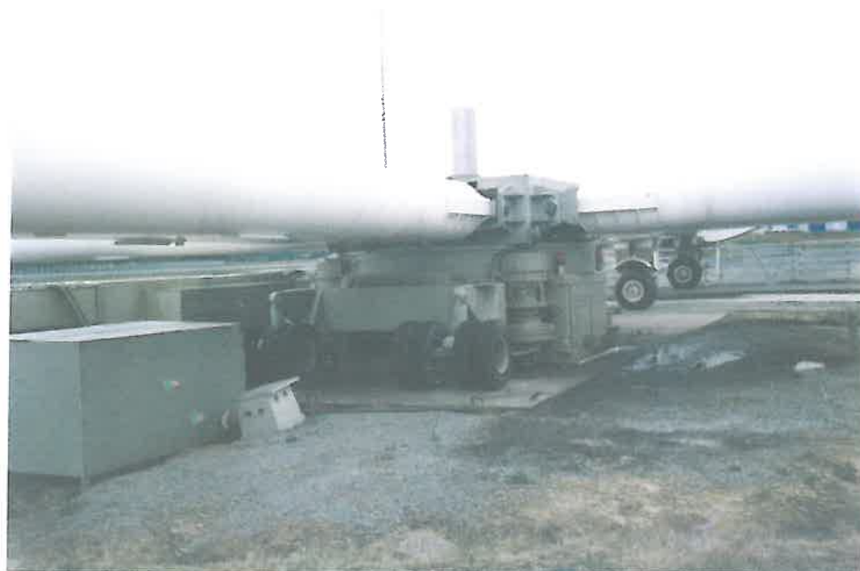
Fig. 2. Turela instalației și unul din motoarele hidraulice
